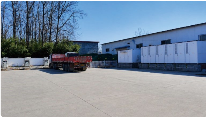
图33 河南新蔡重卡充电站
