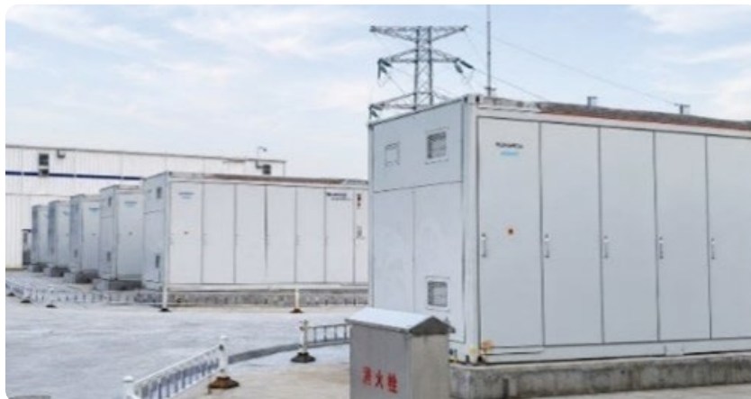
图19 云南文山50MW/100MWh构网型储能项目
