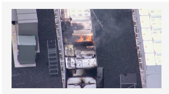
图 23：美国某储能电站因渗水短路起火 (图片来源于主流媒体新闻报道)
