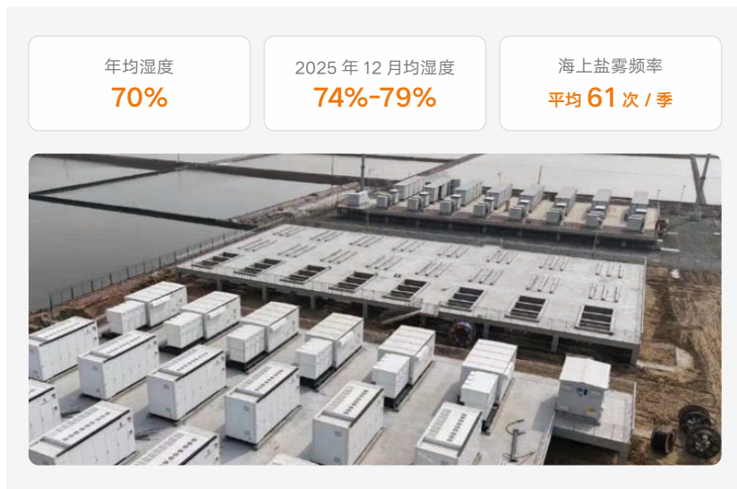
图 24：中国山东潍坊 28MW/56MWh 近海储能项目，运行可靠高效
